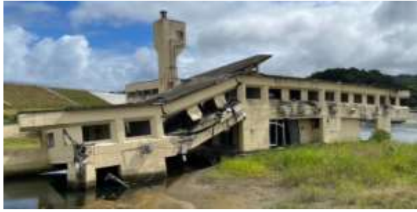
破壊されたホテル
