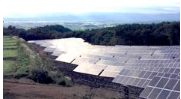
雄国太陽光発電所の太陽光パネル
