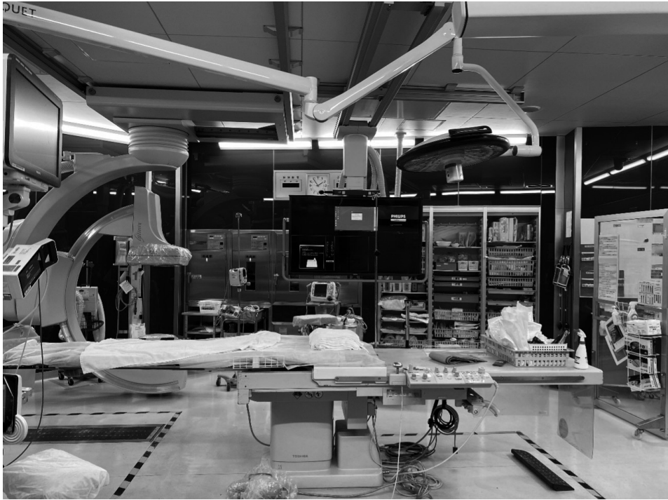
図3 済生会横浜市東部病院のハイブリッドER [25] （救急車の搬送入り口から数メートルの場所に設置されている）
