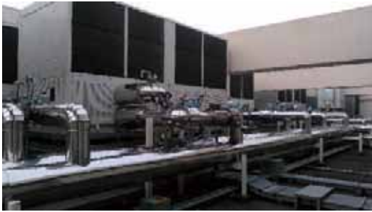
氷蓄熱式空調システム（冷媒サブクールシステム）
