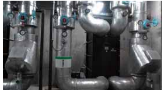
氷蓄熱水式空調システム（熱交換器）
