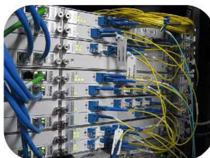
ネットワーク機器 (小金井)
